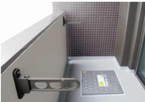
ADC300HBSC マンション設置 施工例
